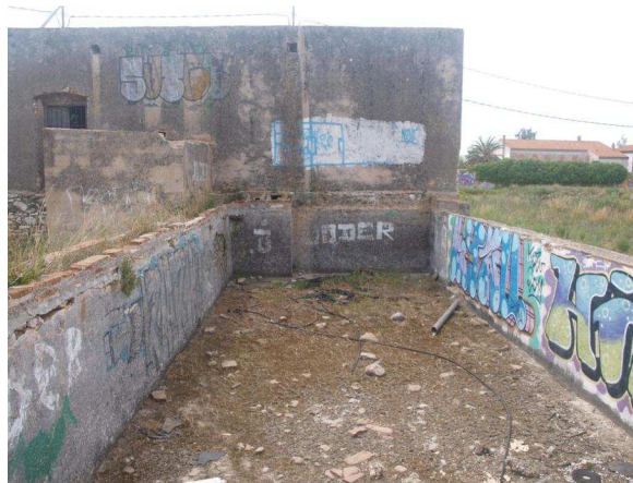
Detalle de la balsa del pozo de riego nº 7
